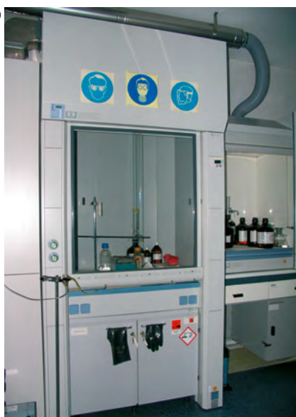
Rys. 9-1. Przykładowe urządzenia wentylacji miejscowej: a) stanowisko do okleinowania listew przyszybowych (zakład produkujący okna), b) stanowisko cięcia płyt w zakładach meblowych, c) dygestorium w laboratorium chemicznym (źródło: CIOP-PIB)
